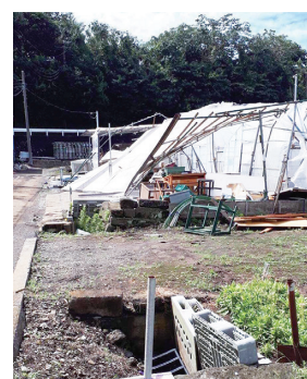
倒壊したイチゴのビニールハウス
